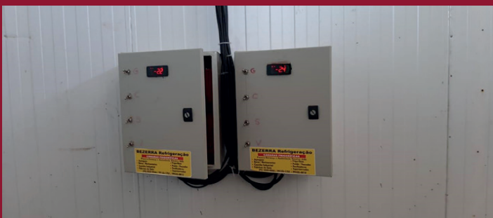
Câmaras frigoríficas montadas
